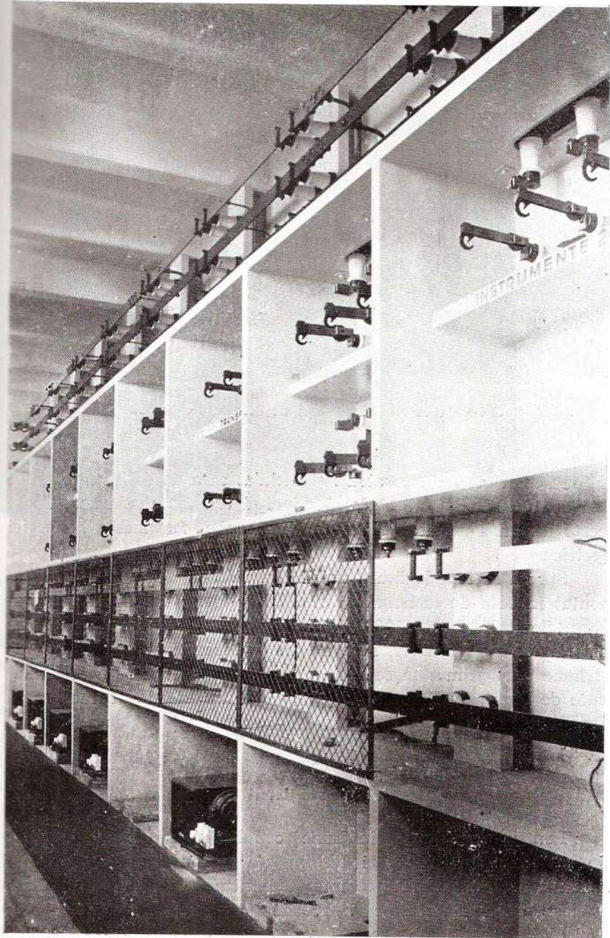
Vedere în casa de distribuție de 10 kV
